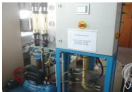
Instalație de purificare a apei prin sisteme cu membrană
