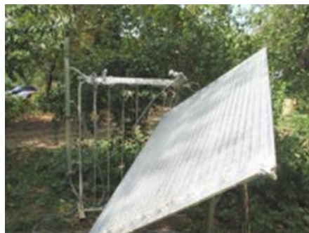
Instalație solară de fotooxidare
